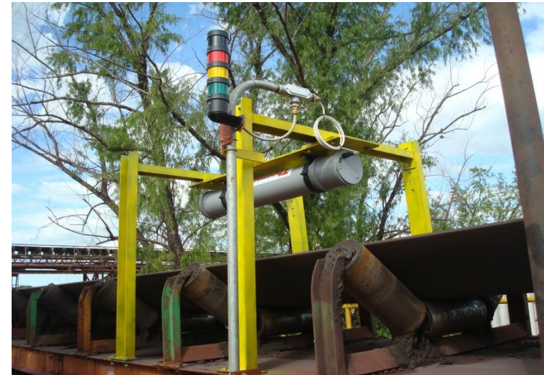
Cinta de descarga de puerto
