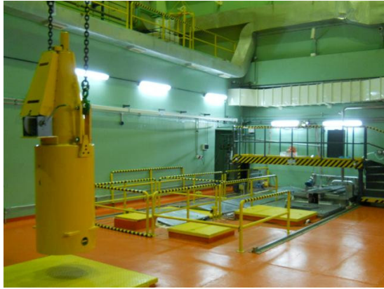
Figura 4: Contenedor de combustibles irradiados desplazándose hacia la zona de piletas en la FACIRI
