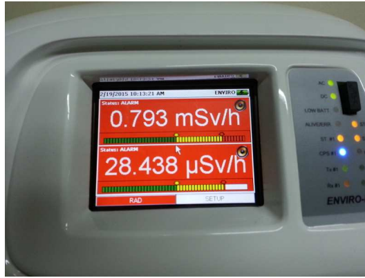
Ilustración 5: central de GMs para enclavamiento de puerta de celdas TAEN
